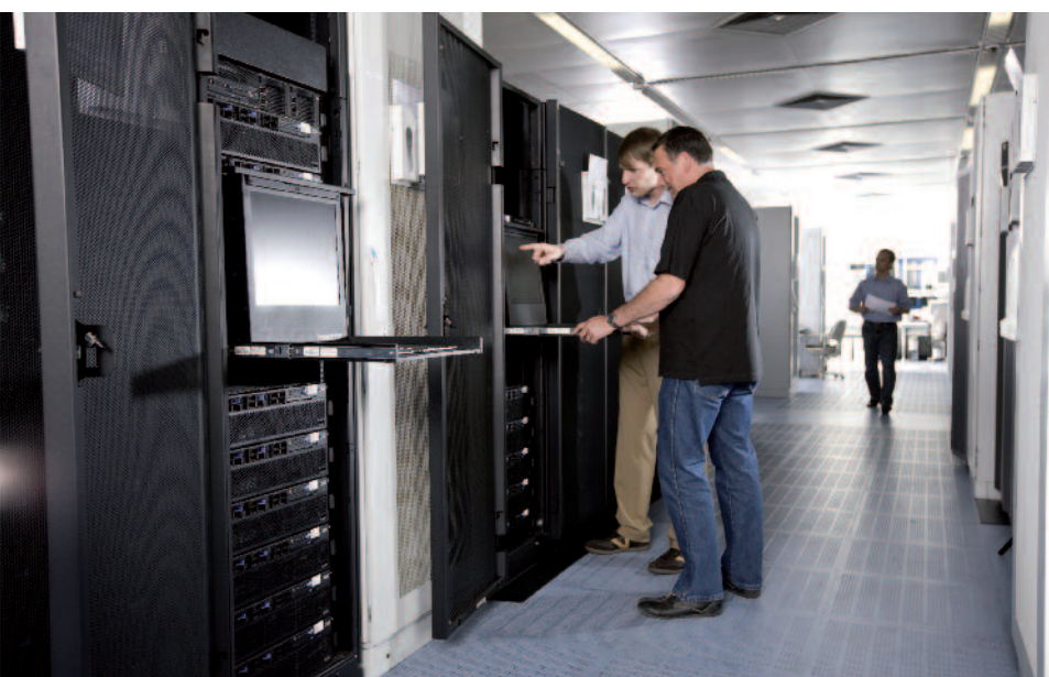
Abb. 1: In das Rechenzentrum Köln-Wahn, welches zu den modernsten der Bundeswehr zählt, hat die BWi in zwei Jahren 2,4 Mio. € investiert, um die Infrastruktur des Rechenzentrums zu verbessern.
